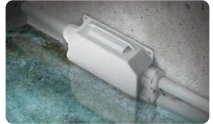
Installatie met kabelleidingen.
