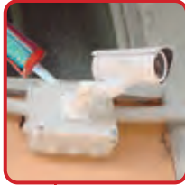
Installations de vidéosurveillance
